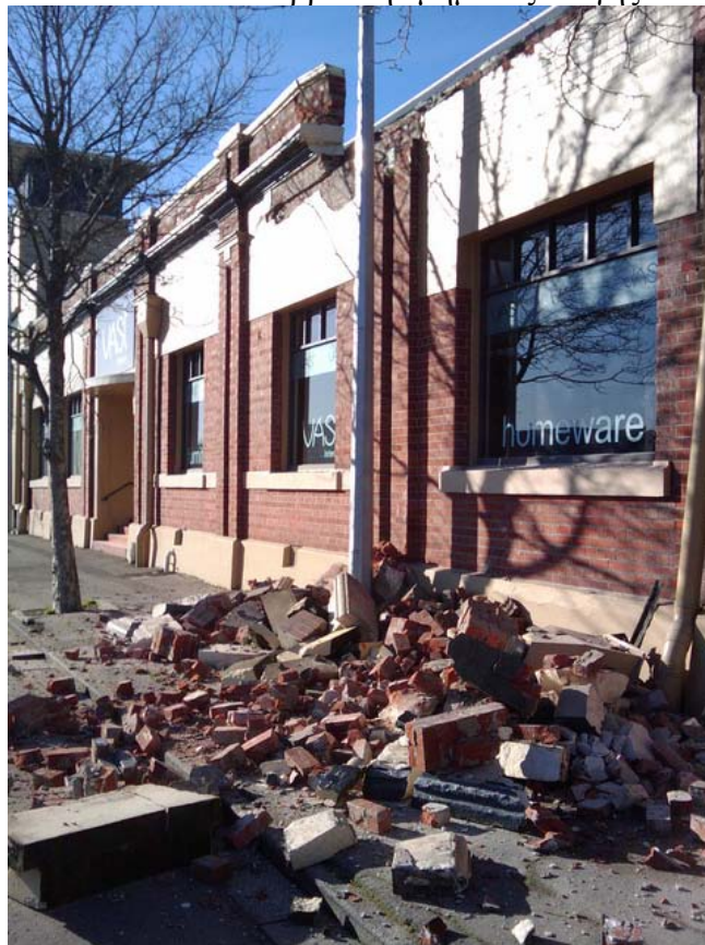
Φώτο 6. Κατάρρευση περιμετρικού στηθαίου
