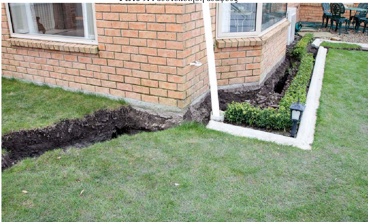
Φώτο 10. Ρήγμα που εξελίσσεται περιμετρικά της κατοικία
