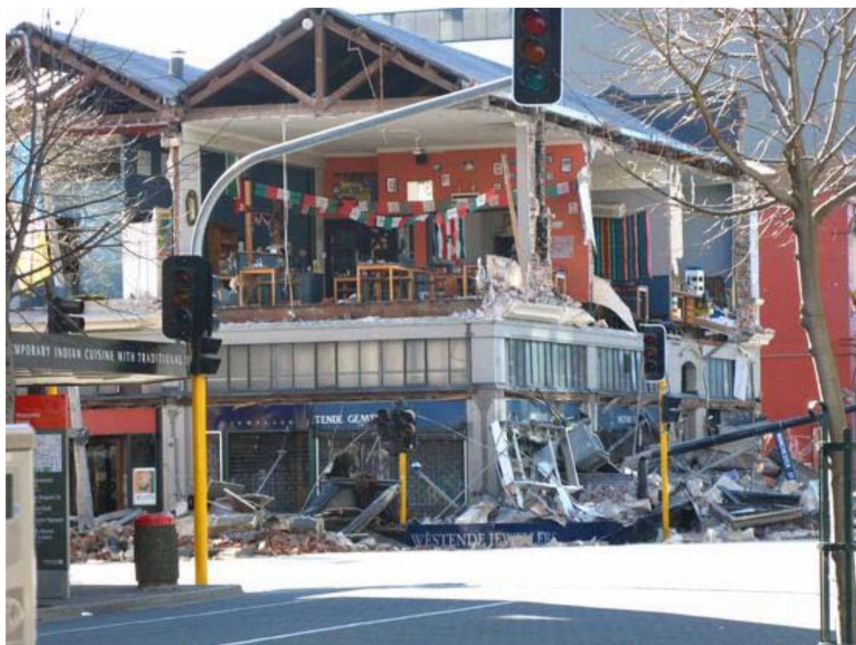
Φώτο 3. Κατάρρευση περιμετρικής τοιχοποιίας. Η τοιχοποιία στην εγκάρσια διεύθυνση απέτρεψε την ολική κατάρρευση
