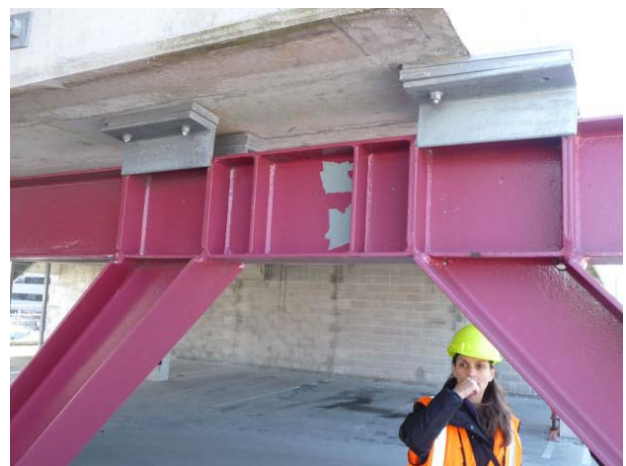
Εικ. 16 Διαρροή συνδέσεων σύζευξης. Κτίριο με φέροντα οργανισμό από προκατασκευασμένα στοιχεία (υποστυλώματα, πατώματα) και μεταλλικό σκελετό με έκκεντρους συνδέσμους, [1],[2],[4]
