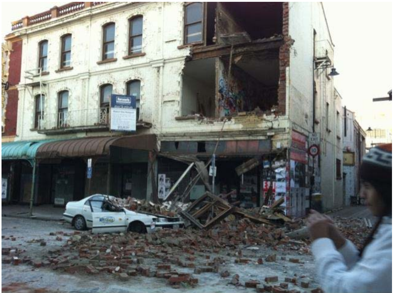
Φώτο 4. Κατάρρευση τμήματος τοιχοποιίας από όροφο λόγω εκτός επιπέδου παραμόρφωσης
