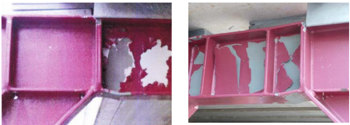
Εικ. 18 Πλάστιμες μορφές αστοχίας δοκών σύζευξης κατακόρυφων έκκεντρων μεταλλικών συνδέσμων
