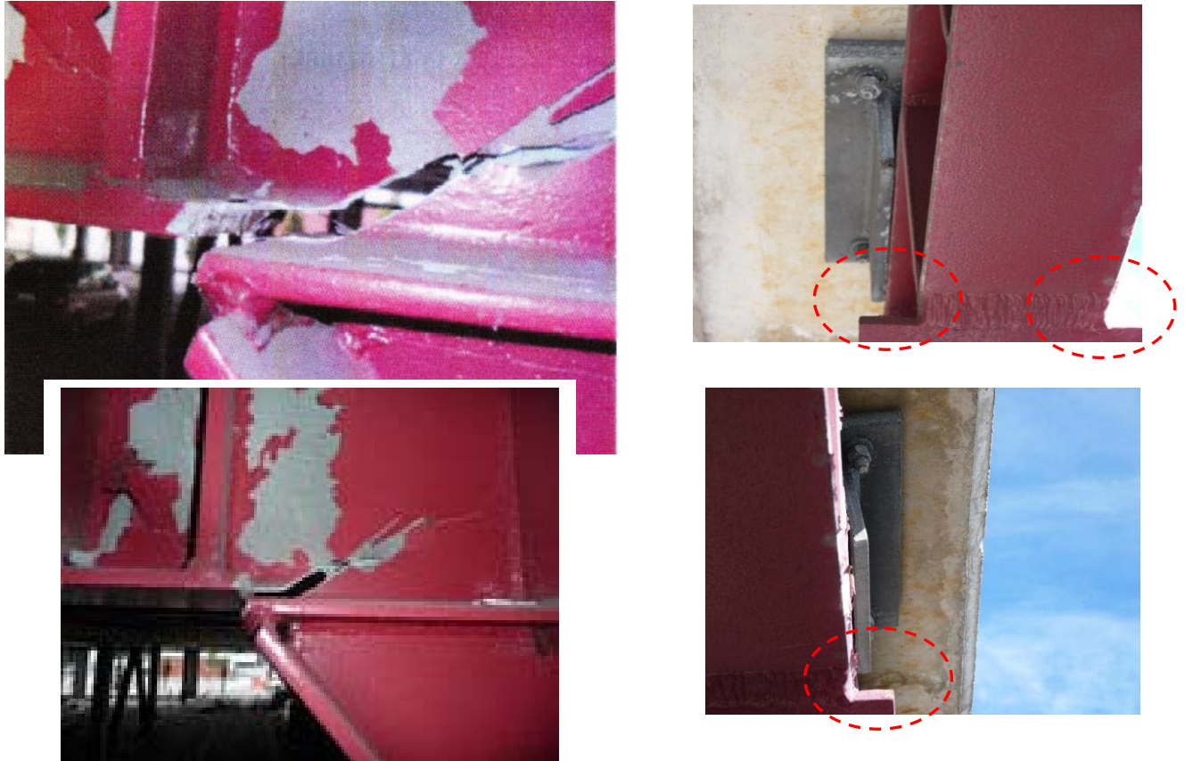
Εικ. 17 Θραύση στην θέση σύνδεσης κατακόρυφου συνδέσμου-δοκού σύζευξης, η οποία αποδίδεται στην ακατάλληλη κατασκευαστική διαμόρφωση. Η πρώτη παγκοσμίως σε σύστημα έκκεντρων συνδέσμων, όπως αναφέρεται στην [3]
