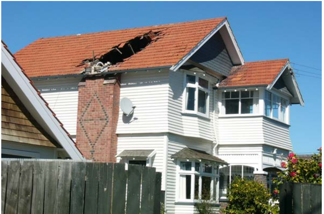
Φώτο 5. Κατάρρευση τμήματος στέγης
